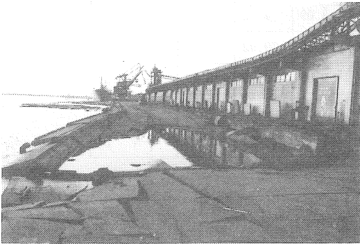
写真2 岸壁の崩壊とはらみ出し(秋田港)
