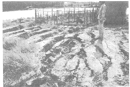
写真9 地割れによる段差
