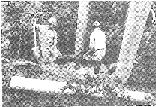
写真8 液状化による電柱の被害
