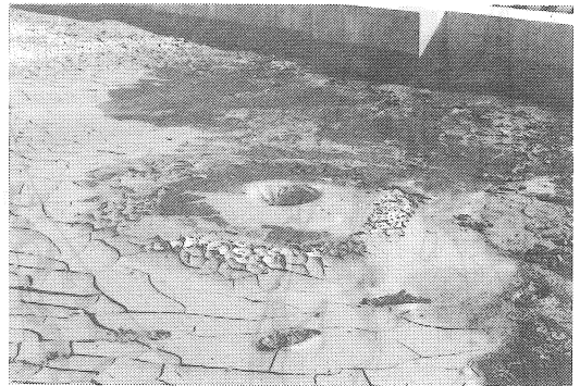
写真5 背後地盤の液状化跡(秋田港)
