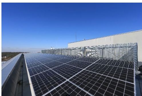
屋上の太陽光パネル
