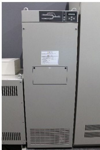
グリッド管理装置(20kVA)
