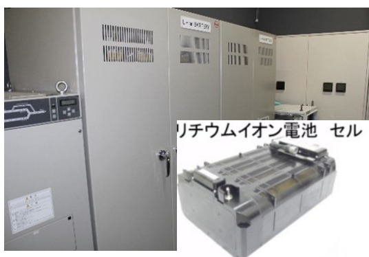
リチウムイオン電池装置
