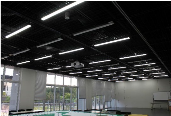
2号館1階に導入した直流LED照明
