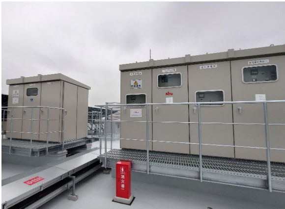
特殊巻線構造変圧器(キュービクル盤)
