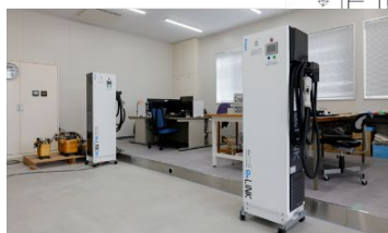
直流給配電・EV給電実験室
