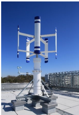
風力発電装置(2kW)
