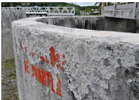
写真-1 ローモンタイトによる表面剥離の様子 11)
