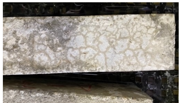
写真-6 屋外暴露させた供試体のひび割れ(材齢 91 日目)
