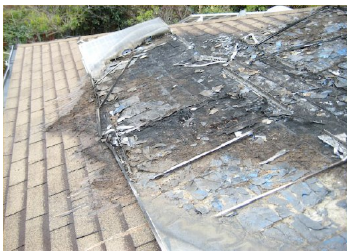
図 1-3 屋根上の太陽電池火災(アメリカ)
