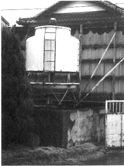
写真 23 クーリングタワー
