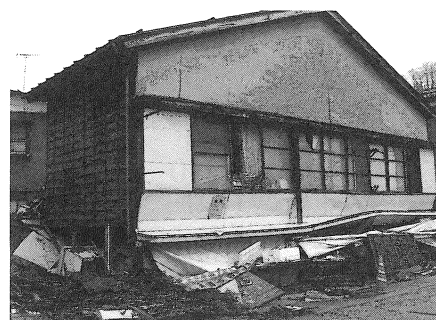
写真2 店舗併用住宅の被害
